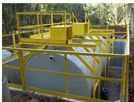
Figura 2: ECTEL NP instalada
