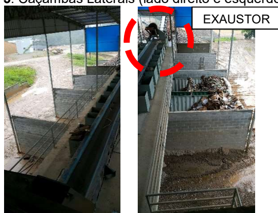
Figuras 4 e 5. Caçambas Laterais (lado direito e esquerdo). Detalhe do exaustor.
