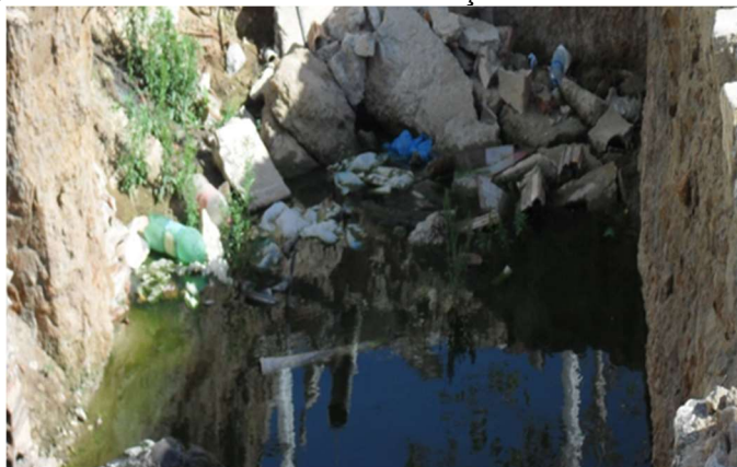
Figura 04: Descarte de resíduos de construção e doméstico em um canal.
