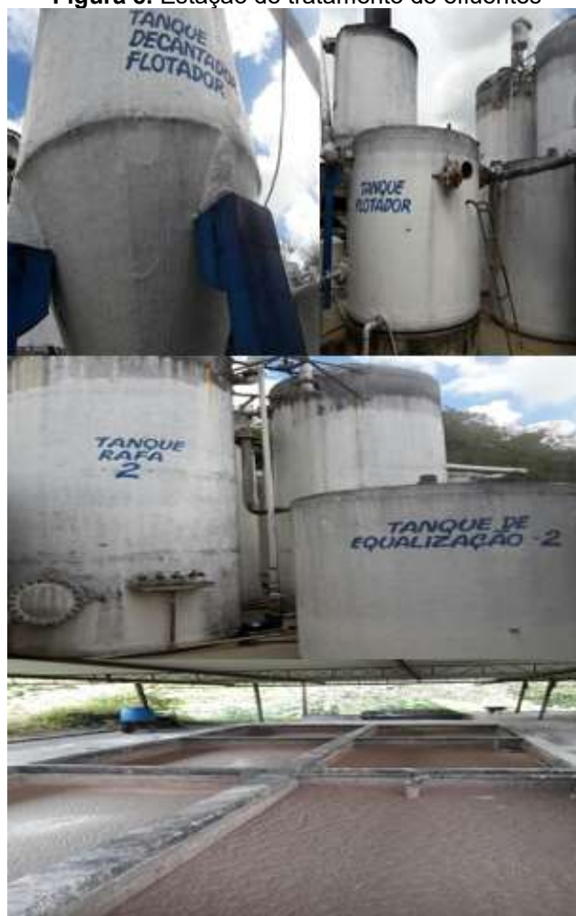
Figura 8. Estação de tratamento de efluentes
