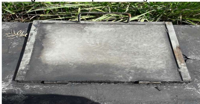
Figura 9. Caixa separadora de água e óleo
